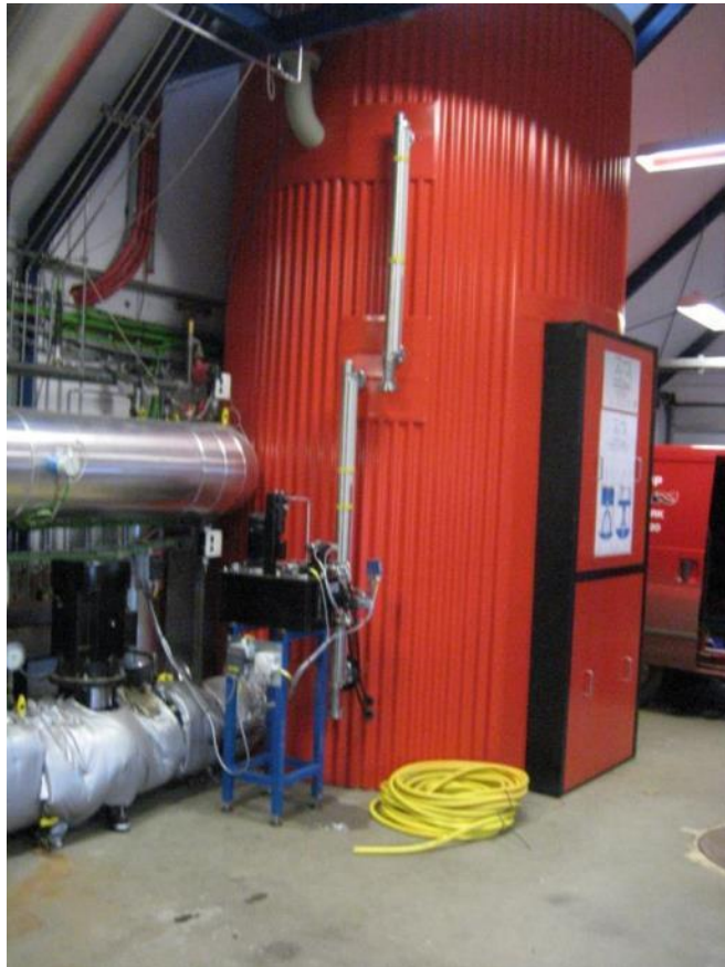
Bild: BVA Heißwasserkessel
