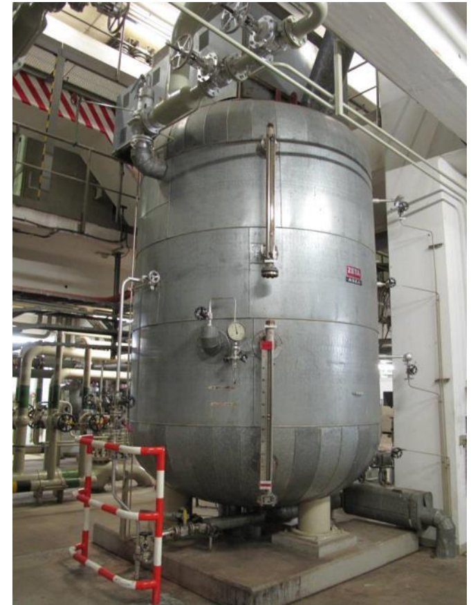
Bild: ZDK Dampfkessel
