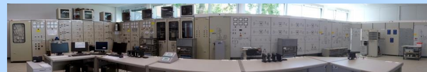
Labor für el. Energiesysteme, Jade Hochschule Wilhelmshaven
