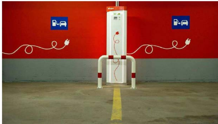
Ladestation für Elektrofahrzeuge
