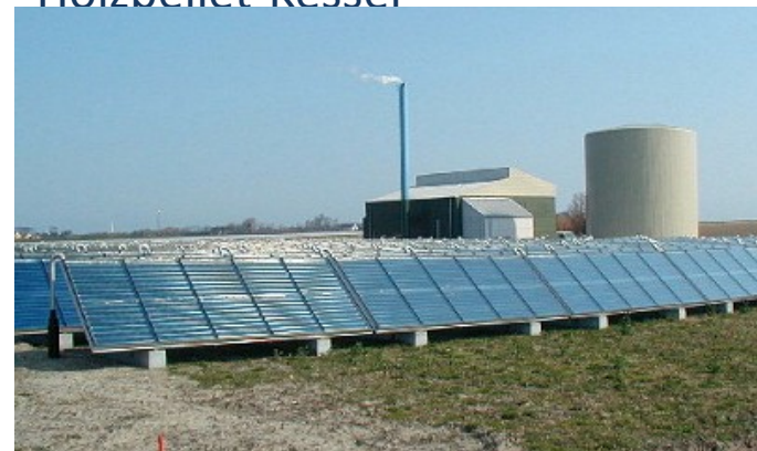
Nordby 2 500 m 2 / 1,8 MW kombiniert mit Holzhackschnitzel-Kessel
