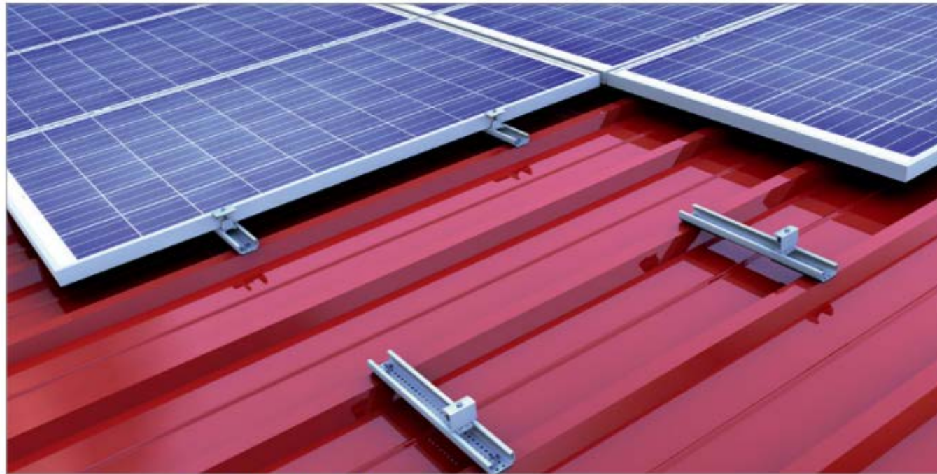
Klemmsystem mit Direktbefestigung und hochkant montierten Modulen
