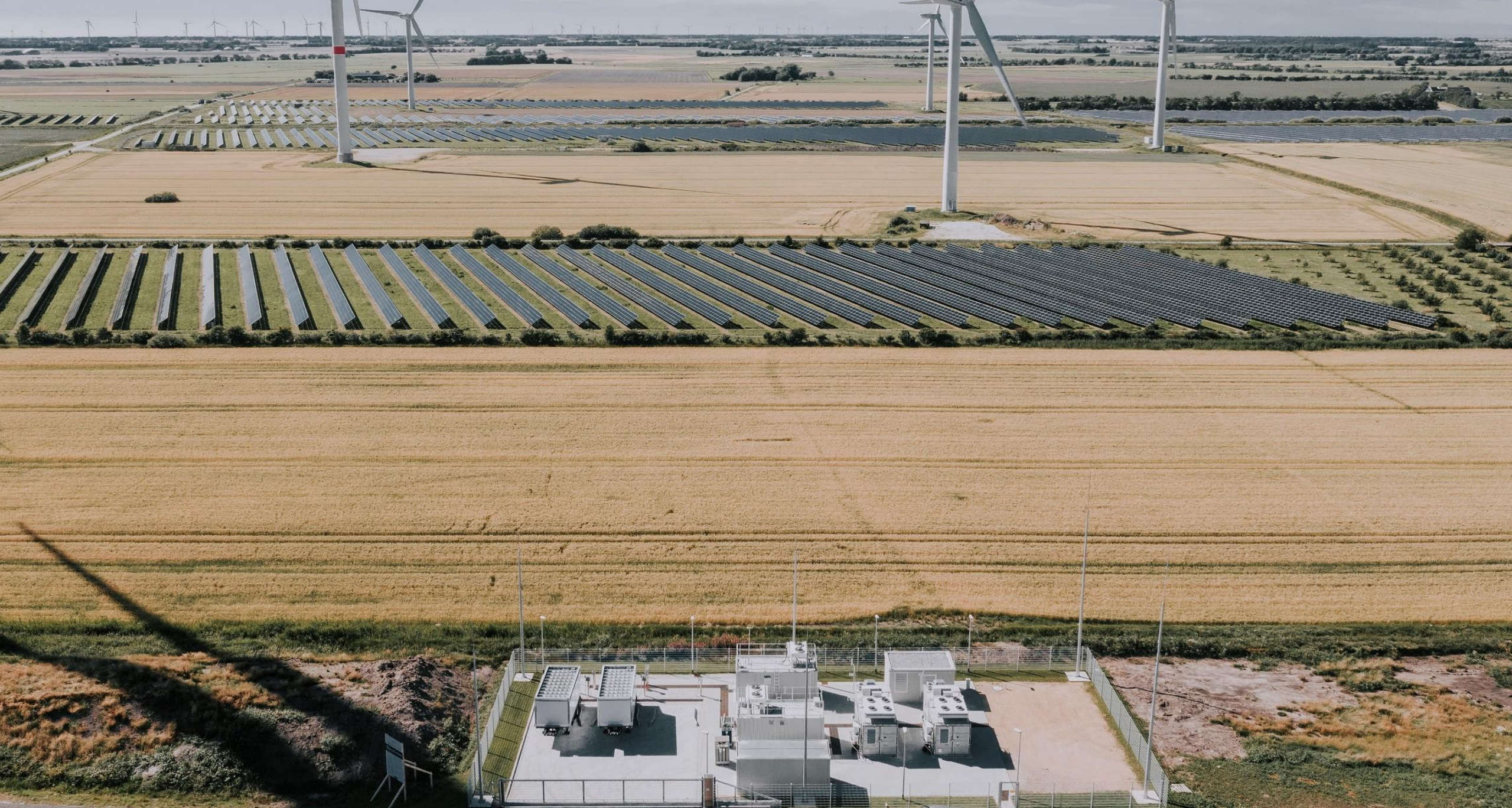
Wasserstoff- und Wärmeerzeugung in Bosbüll
